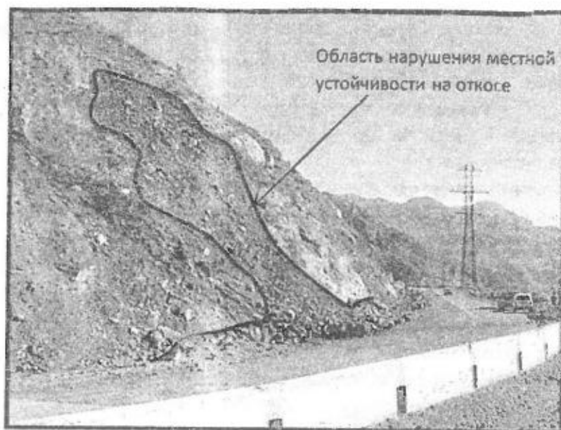
Рис. 1. Нарушение местной устойчивости откоса на автомобильной дороге Бишкек-Ош на участке 400+700-400+820 км
