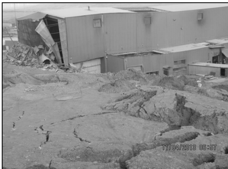
Рис. 8. Надвигание ледово-каменной массы отвалов на здание АТК.
